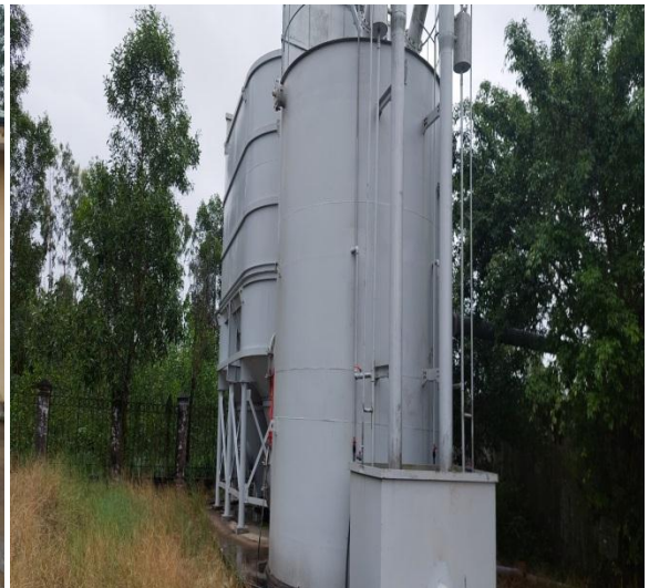
Hình 1. 4. Hệ thống xử lý nước sạch
