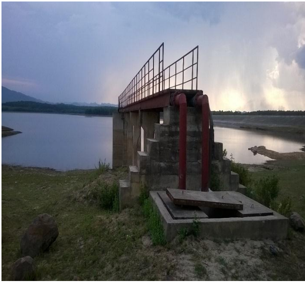
Hình 1. 1. Giếng thu nước tại hồ Vực Nồi
